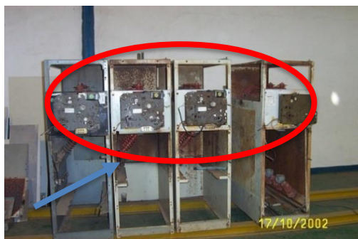
Gambar 1. Corona discharge pada Cubicle 20 kV
